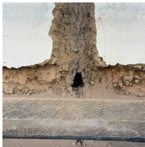
Peça estrutural externa degradada. Autoria: Eduardo Santos Data: 04/02/2025
